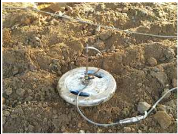
처짐계 설치 현황
