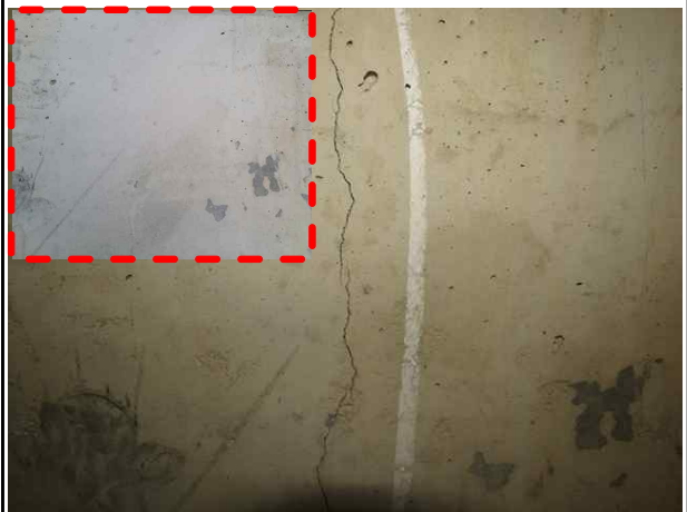
교대 A2 균열(폭 0.3mm)(보수완료)
