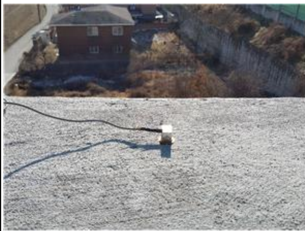
가속도계 설치 현황
