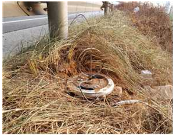
처짐계 설치 현황
