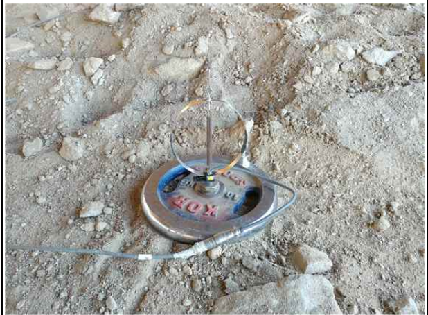
처짐계 설치 현황
