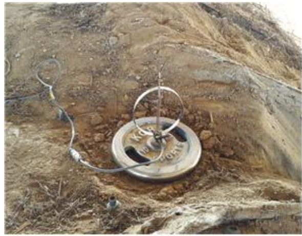
처짐계 설치 현황
