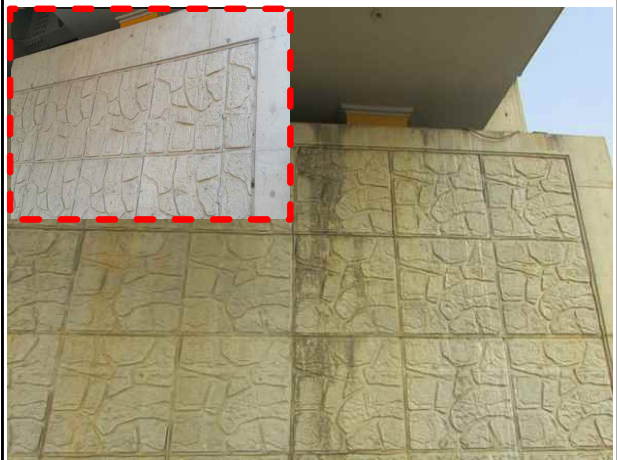
교대 A2 전면벽체 표면오염(보수완료)
