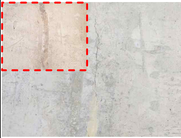
교대 A1 균열(폭 0.3mm)(보수완료)
