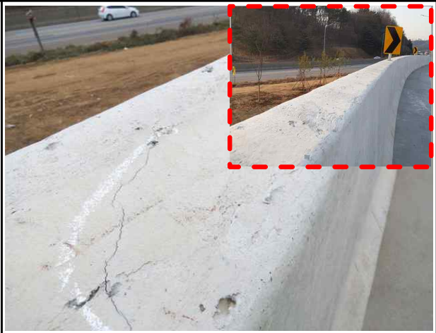
방호벽 균열(폭 0.3mm 미만)(보수완료)
