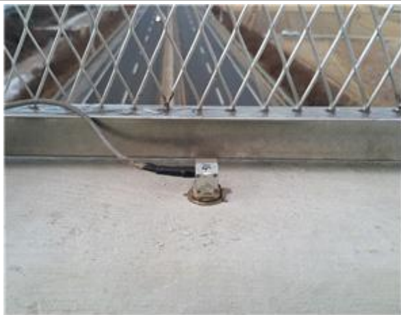
가속도계 설치 현황
