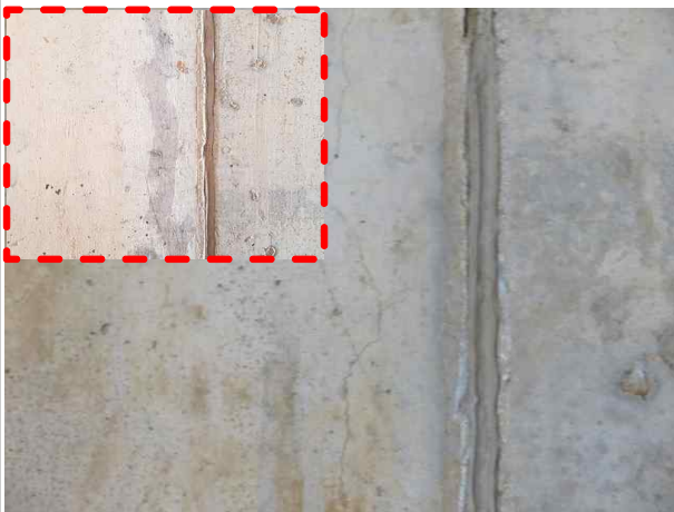
교대 A1 균열(폭 0.1mm)(보수완료)
