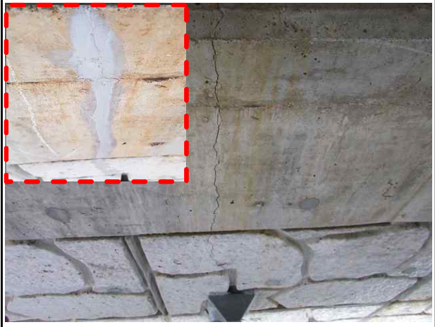
교대 A2 균열(폭 0.3mm)(보수완료)
