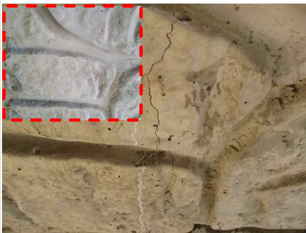
교대 A1 균열(폭 0.3mm미만)(보수완료)
