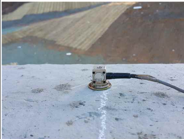
가속도계 설치 현황
