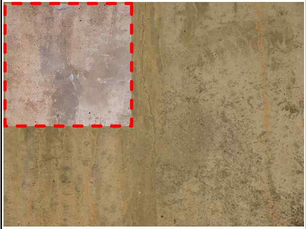
교대 A1(옥산방향) 균열(폭 0.3mm미만)(보수완료)
