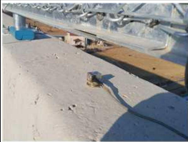
가속도계 설치 현황
