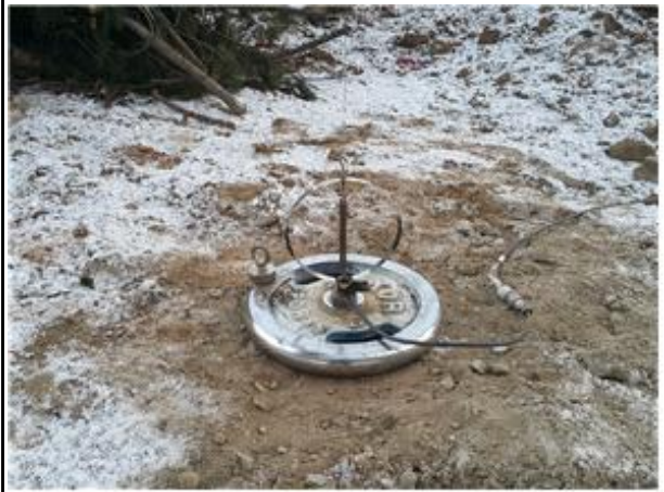
처짐계 설치 현황
