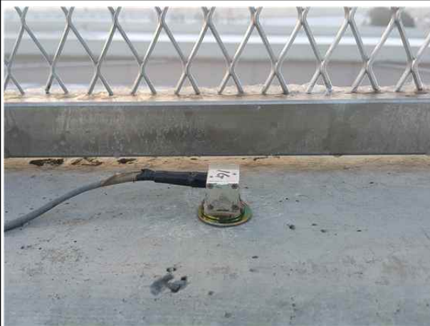
가속도계 설치 현황
