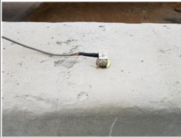
가속도계 설치 현황
