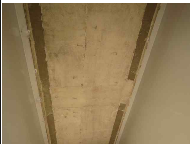
바닥판 하면 상태양호
