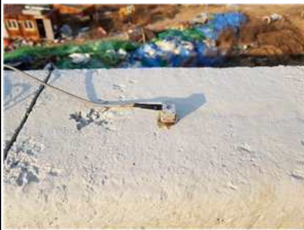
가속도계 설치 현황
