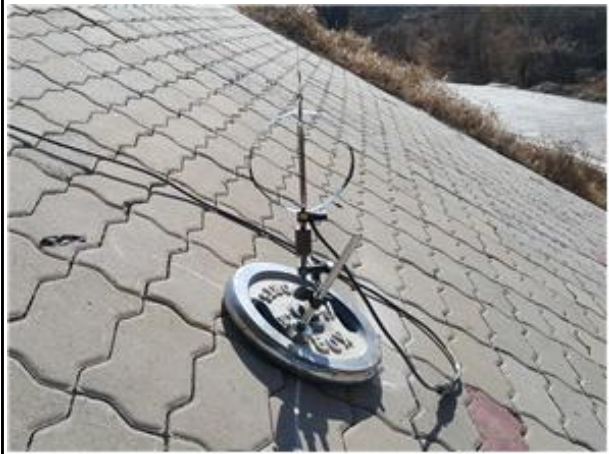
처짐계 설치 현황
