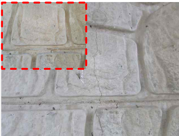
교대 A1 전면벽체 균열(폭 0.3mm이상)(보수완료)
