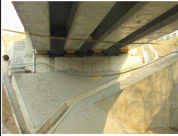
교대 A1 상태양호
