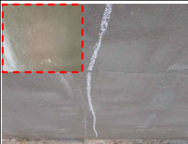
바닥판 하면 균열(폭 0.1mm)(보수완료)
