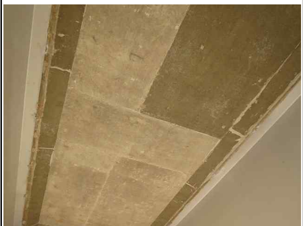
바닥판 하면 상태양호
