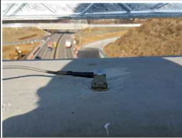
가속도계 설치 현황
